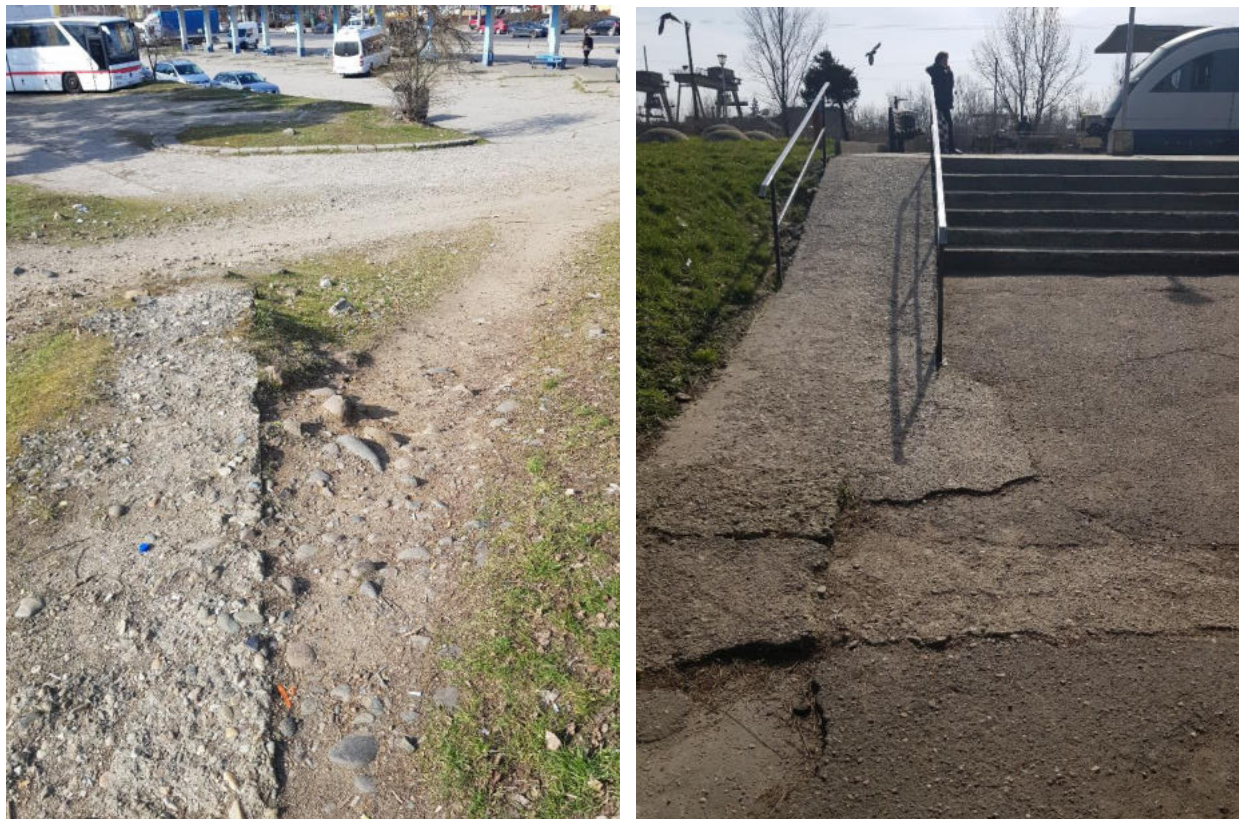
Figură 2-61 - Imagini reprezentative zona Autogării și Gării - Lipsa rampelor sau prezența rampelor incorect proiectate
